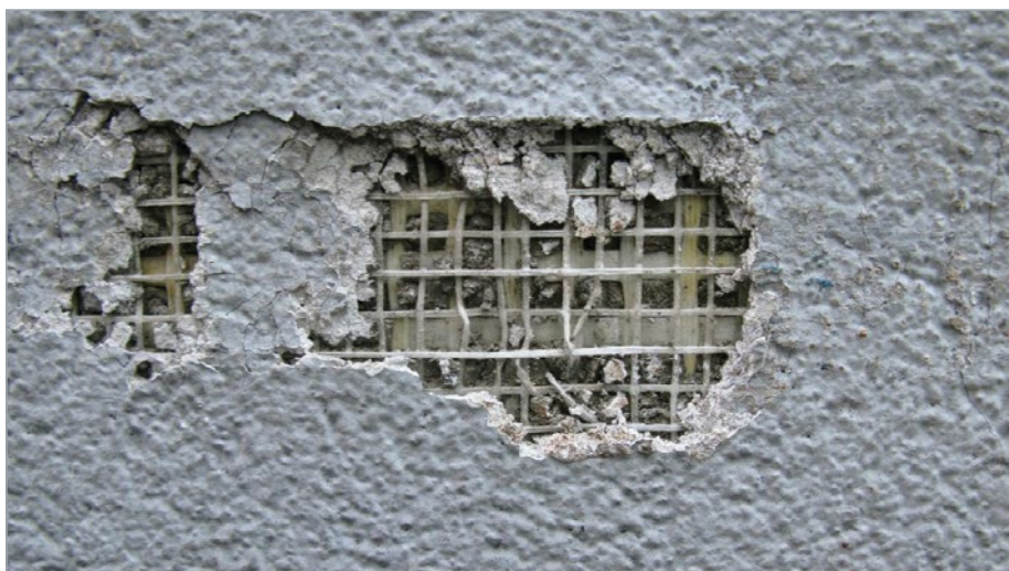
Zdjęcie nr 5 - Uszkodzona ściana
