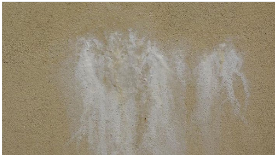
Zdjęcie nr 2 - Plamy solnet na elewacji.
