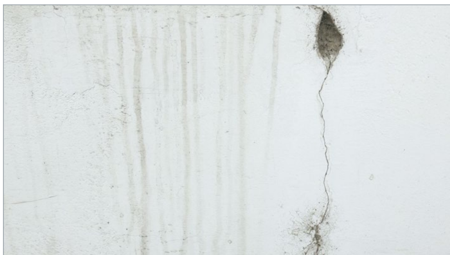
Zdjęcie nr 3 - Pęknięcia na elewacji.
