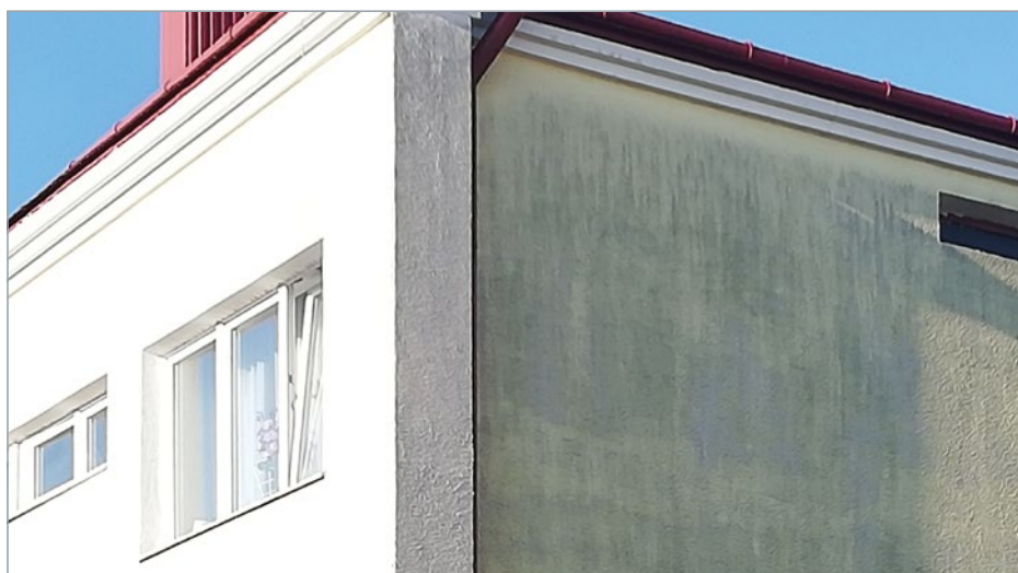
Zdjęcie nr 6 - Skażenie mikrobiologiczne elewacji.
