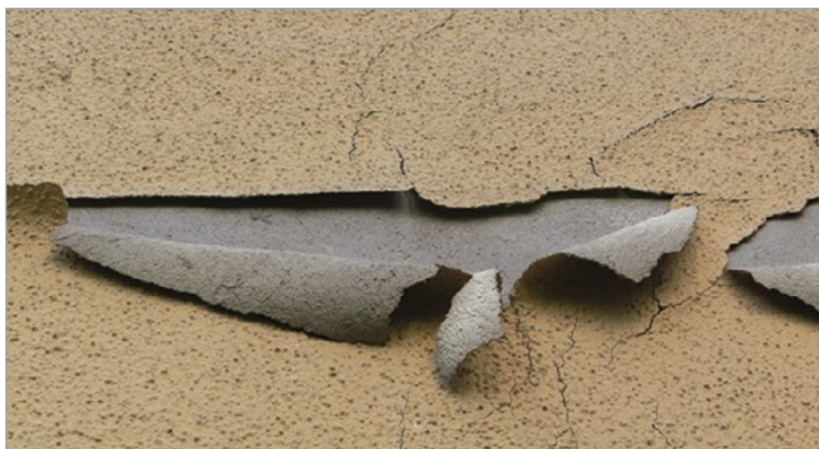
Zdjęcie nr 4 - Odspojenie tynku.
